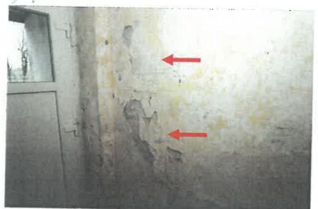
Schäden im Wandbereich
