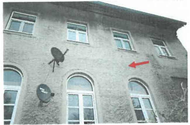
Setzungsrisse im Mauerwerk
