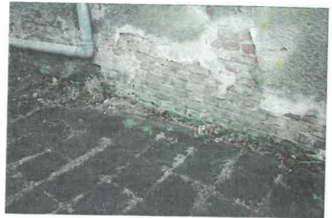
flächige Schäden im Sockelbereich
